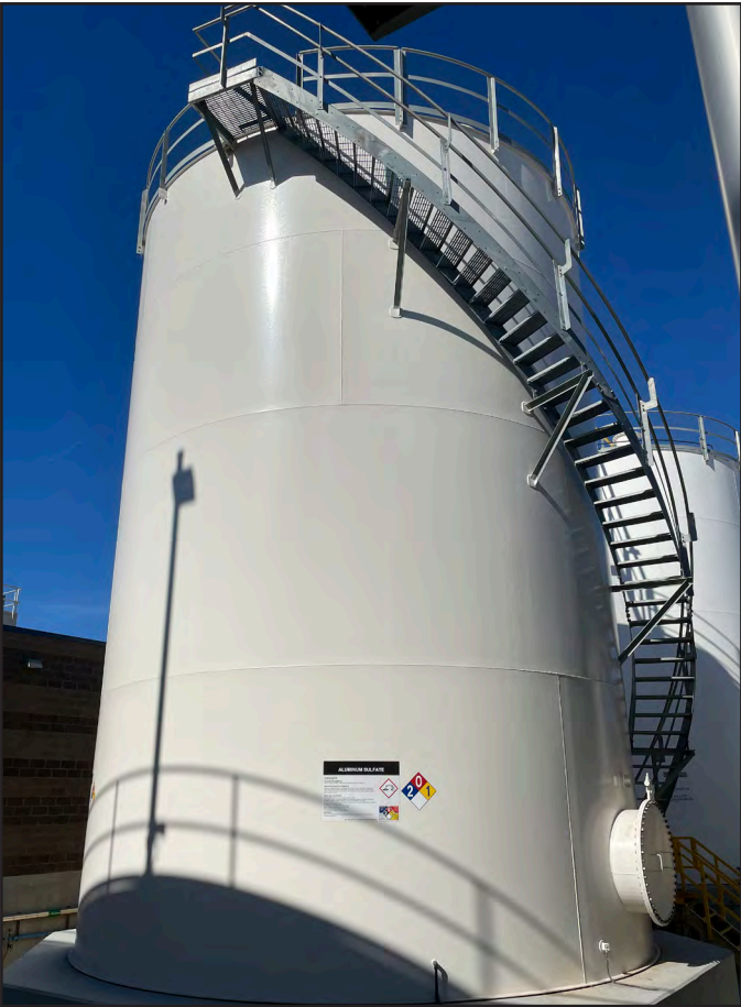
Tanque de agua de retrolavado
